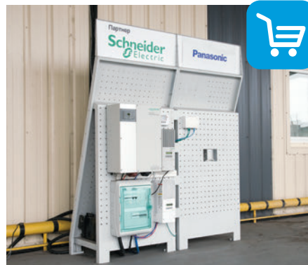
Центр управления, мониторинга и распределения энергии
