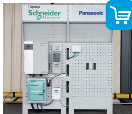
Центр управления, мониторинга и распределения энергии
